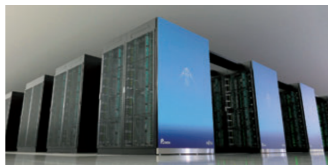
5月に設置完了した「富岳」
