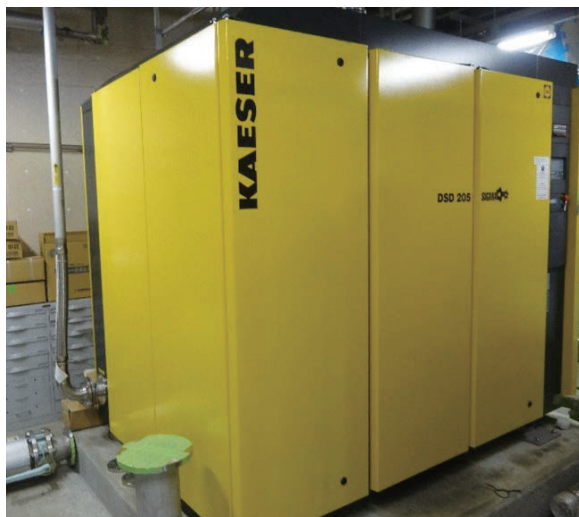
更新したヘリウム液化設備
