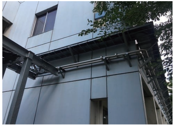
特定施設対象設備(架空配管)
