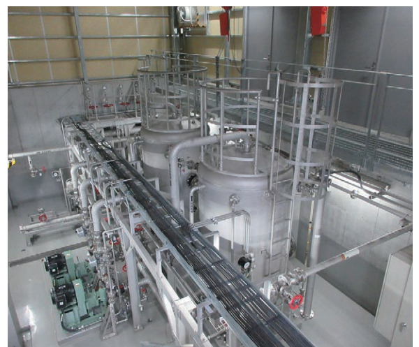
真空排水設備
