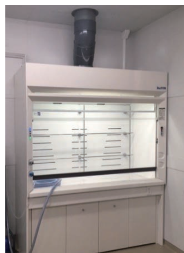
検査対象の局所排気装置
