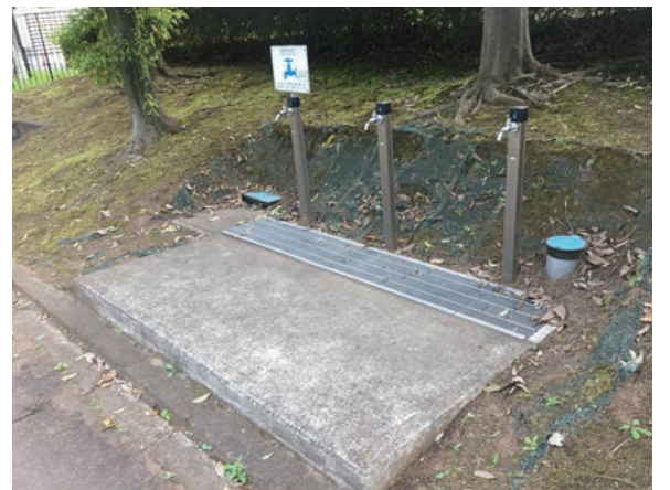
外周柵の外に設置した分岐水栓
