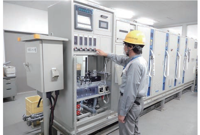
水質自動監視装置
