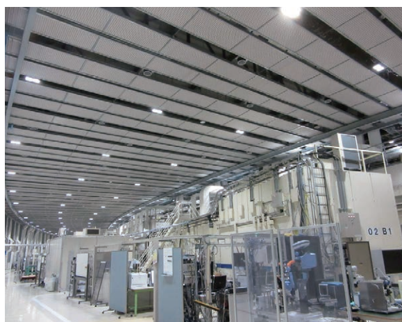
蓄積リング棟実験ホールLED
