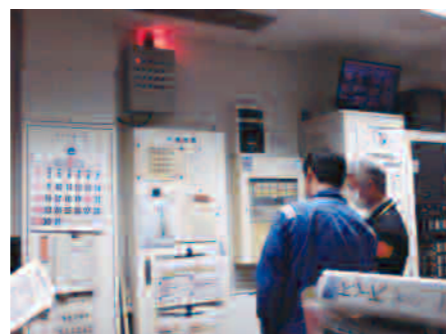
アラーム鳴動時の様子
