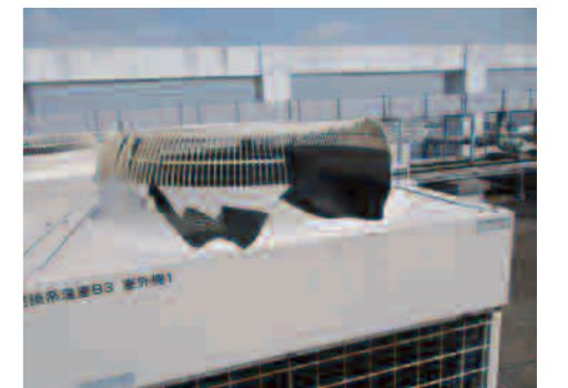
屋外にある室外機の破損
