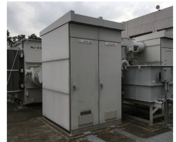
筑波地区構内へ電気の供給を行う特別高圧受変電設備
