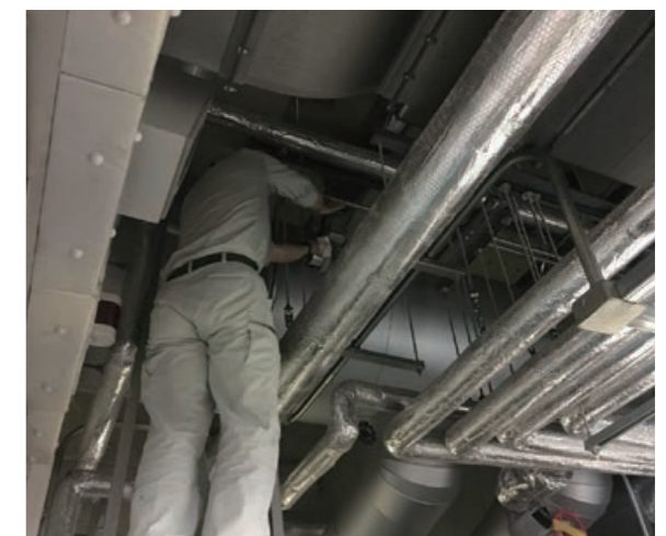
ばい煙濃度計定期清掃の様子
