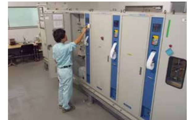
水質自動監視装置
