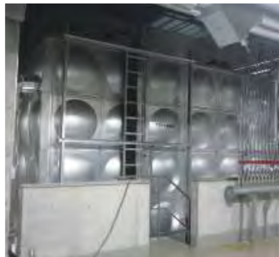
蓄熱槽 蓄熱容量:1.2GJ 2次ポンプ:6,000L/分
