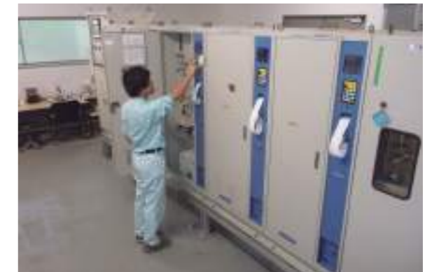
水質自動監視装置
