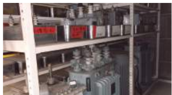
漏洩対策などの措置を行い保管しているPCB含有廃棄物保管庫
