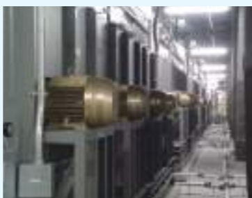
空調機用モーター
