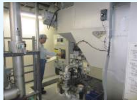
冷温水発生機の日常点検の様子
