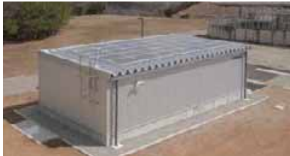
真空排水施設太陽光発電設備
