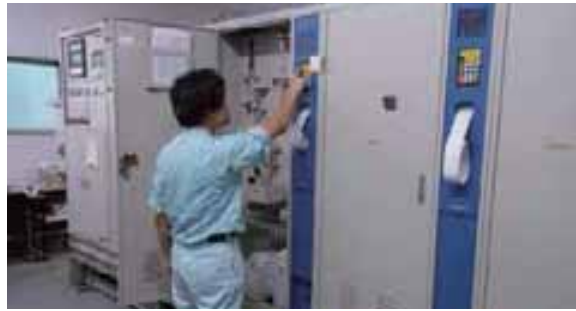
水質自動監視装置
