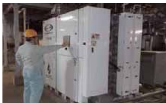
排水から有害物質を取り除く中水化システム
