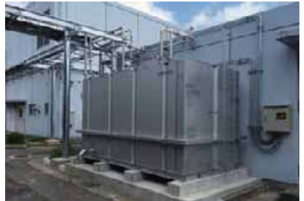
実験排水処理のための中継槽
