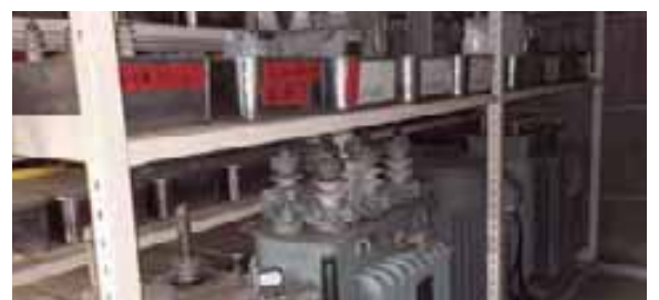
漏洩対策などの措置を行い保管しているPCB含有廃棄物保管庫
