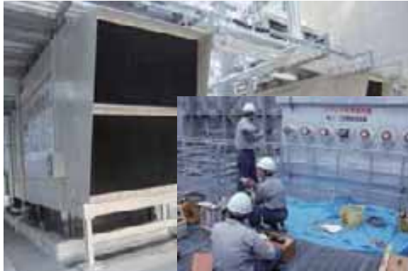
熱源機械棟「コージェネレーションシステム」
