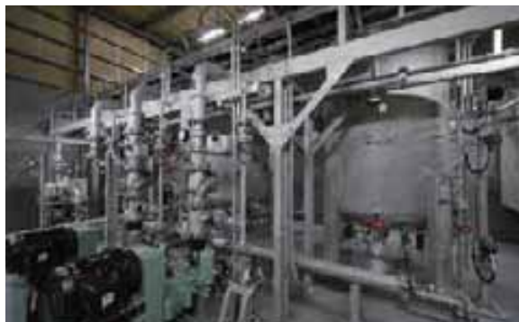
真空排水施設機械設備
