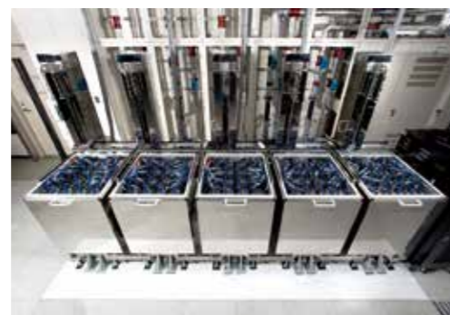
液浸槽5台による液浸冷却が大きな特徴
