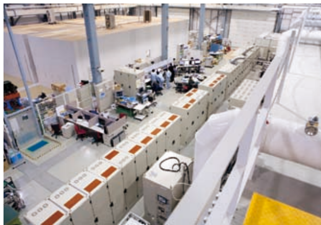
図1 XFELプロトタイプ機における制御室の様子 XFEL実機に先立って、2005年にプロトタイプ機を建設。現在はプロトタイプ機を使ったテストを行っている。手前から中央奥に向かって様々な機器の入ったラックが並び、加速器を制御している。
