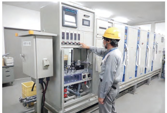
■水質自動監視装置
