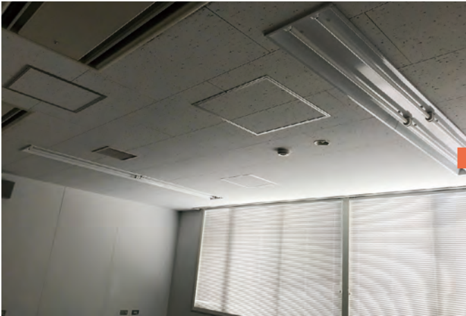
③照明器具LED化前
