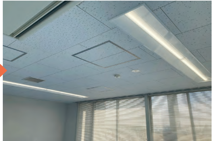
④照明器具LED化後
