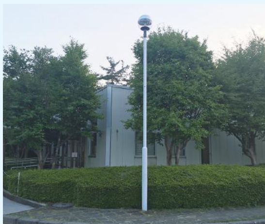
LED照明(外灯)
