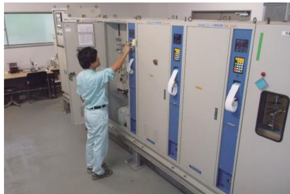
水質自動監視装置
