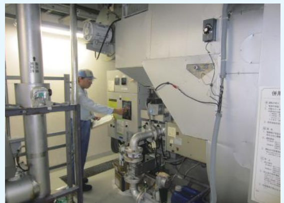
冷温水発生機の日常点検の様子
