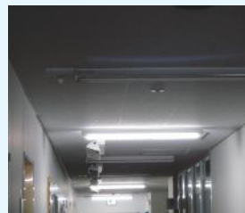
廊下の間引き照明
