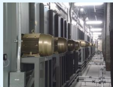
空調機用モーター
