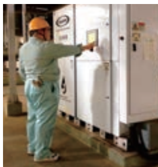
排水から有害物質を取り除く中水化システム
