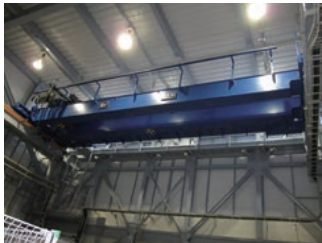
施設内のクレーン
