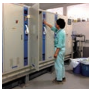
水質自動監視装置
