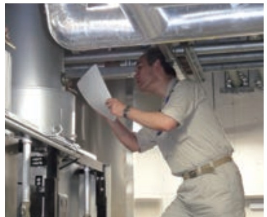
ボイラー設備の日常点検の様子
