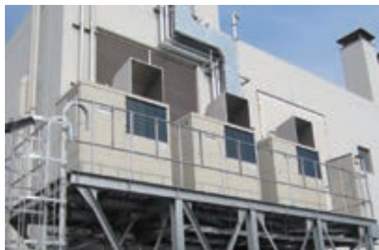
コージェネレーションシステム
